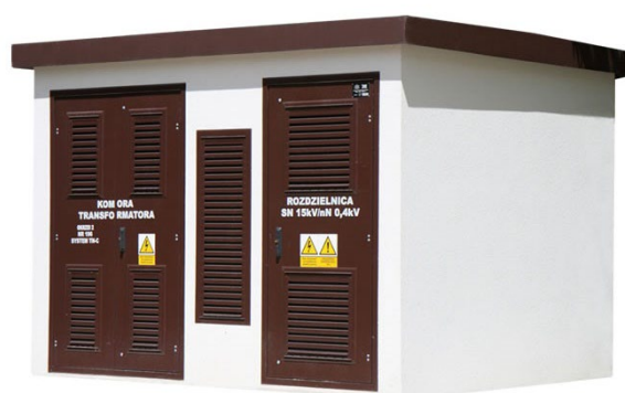
Fotografia 4 Przykładowa kontenerowa stacja elektroenergetyczna
