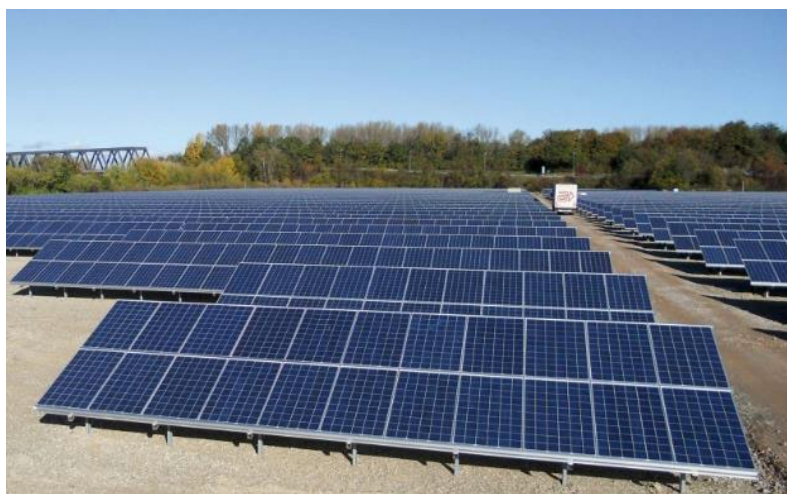
Fotografia 6 Elektrownia fotowoltaiczna w Iffezheim (źródło: http://www.wuerth-solar.de/solar/de/wuerth_solar_2012/unternehmen_1/referenzen_4/referenzen_12/referenzen.php 05.11.2012)
