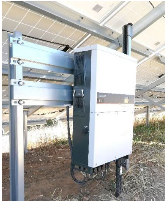
Fotografia 3 Przykładowy inwerter zlokalizowany pod panelami fotowoltaicznymi
